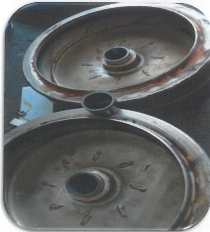
Cambio de anillos en bombas
